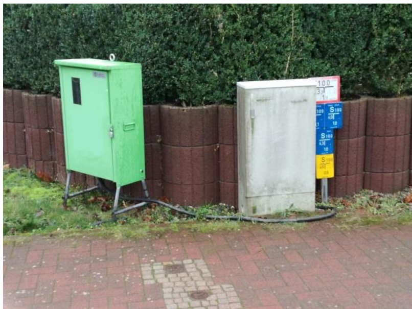
Baustromverteiler der Stadtwerke Geesthacht
