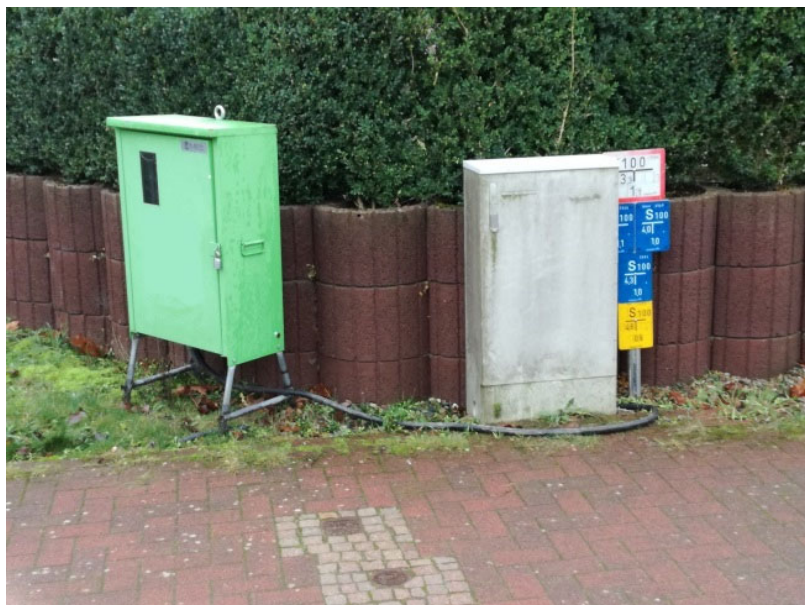
Baustromverteiler der Stadtwerke Geesthacht
