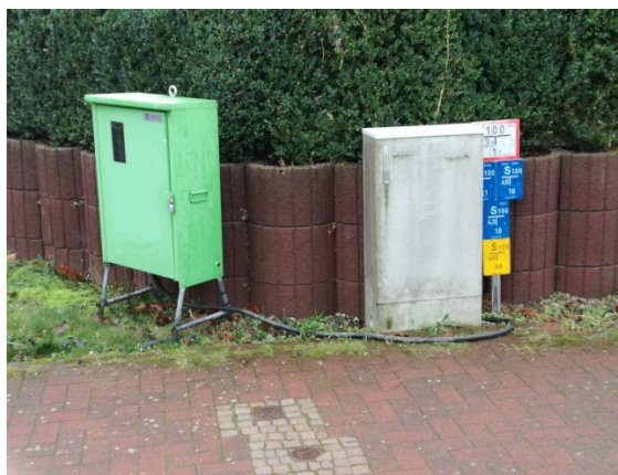
Baustromverteiler direkt an KVS
