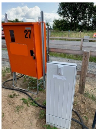
Baustromverteiler mit Vorverlegung KVS
